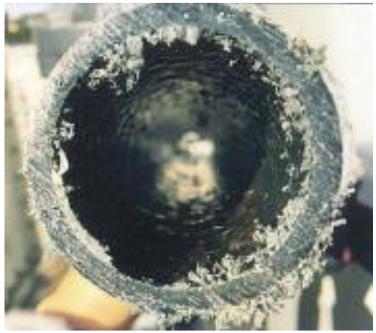
UF膜模塊原水入口側配管
