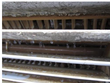
EMIIR設置前（新設）
