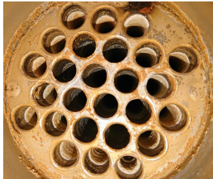
EMIIR設置 使用9個月後 熱交換器出口側（幾乎看不到堵塞）
