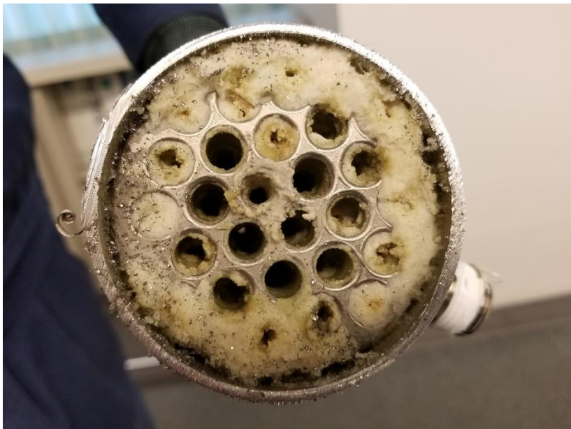
EMIIR未設置 使用9個月後 熱交換器出口側（水垢堵塞）
