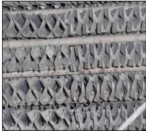
公司某獨立封閉式冷卻塔因藥劑 注入裝置出現問題，導致藥劑注入 裝置停運3天后的內部銅管狀況
