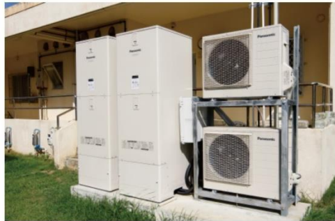
市営住宅に設置されたネットワーク型エコキュートは給湯調整と温水提供を兼ねる
